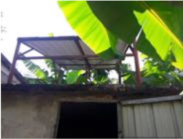
Die Ende 2015 installierten Solarpanels
