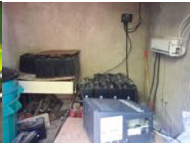
Batterien und Inverter (Umwandler)
